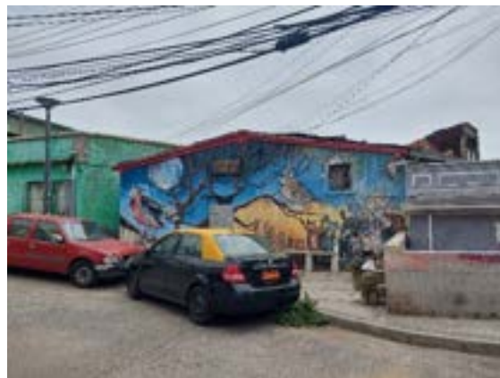
Estado actual de la estación superior, calle Lastra, año 2023. Se aprecia la oxidación de las planchas de acero galvanizado en la cubierta.
