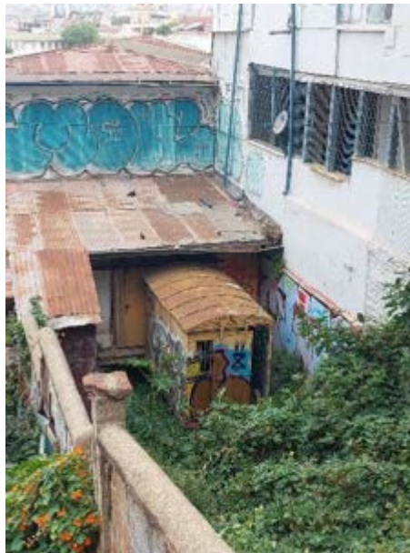
Estación inferior, carro en estado de abandono, oxidado, con grafitis. Vegetación cubre toda la extensión de los rieles-2023.
